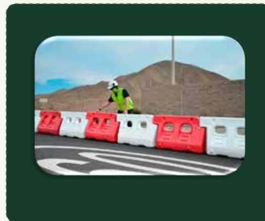
Barreras de separación de caminos
